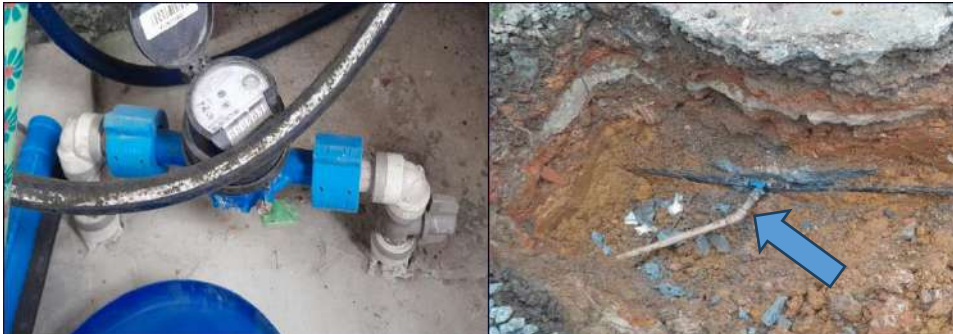
Foto 60 – Hidrômetro chumbado dentro do imóvel Encontrado by-pass (derivação) - Seta
