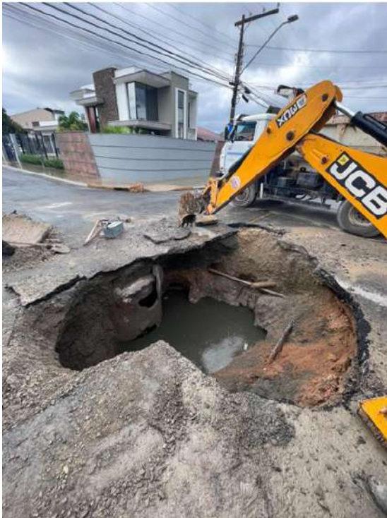
Foto 83 – Poço de Visita a ser Reparado
