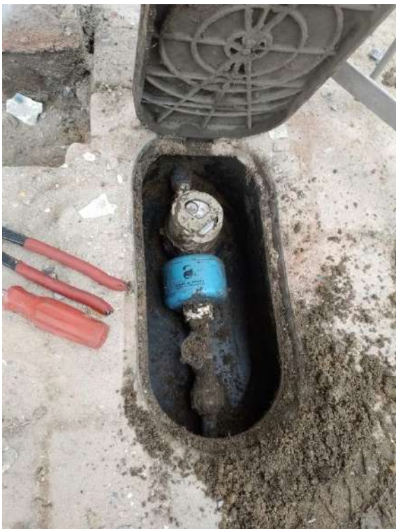
Foto 6 – Caixa Passeio Durante a Limpeza
