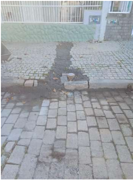
Foto 48 – Calçamento a ser Refeito
