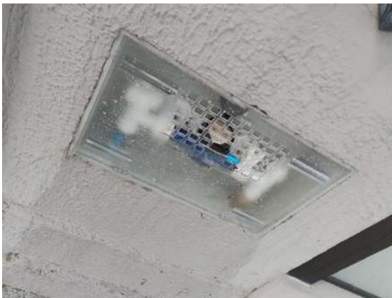
Foto 4 – Caixa Padrão após Limpeza, já com tampa de acrílico
