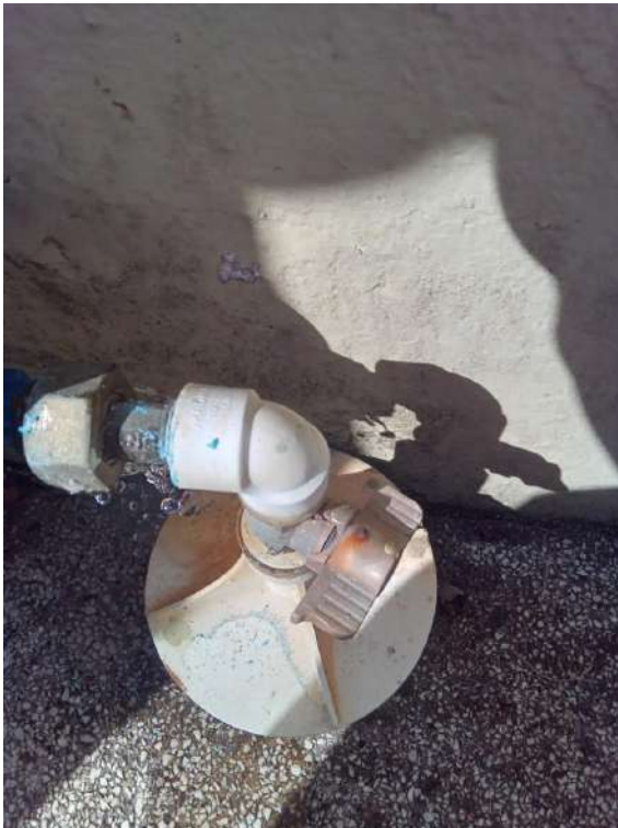
Foto 17 – Registro do Cavalete Não Funcional
