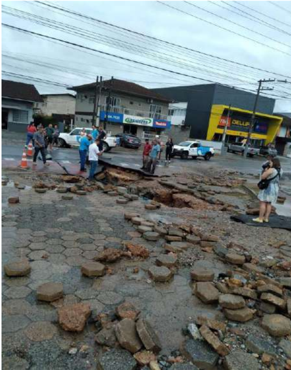
Foto 81 – Vazamento em Adutora
