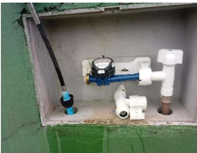
Foto 63 – Corte ramal em Caixa Padrão
