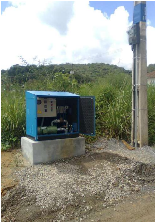
Foto 80 – booster de calçada
