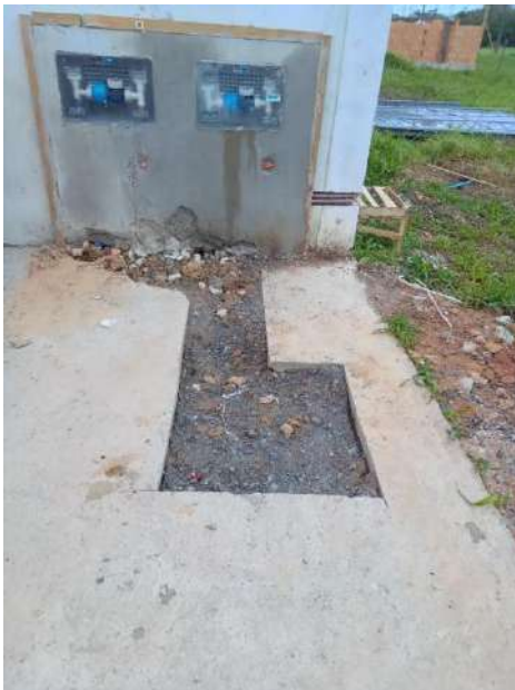
Foto 51 - Área a ser refeita em cimento
